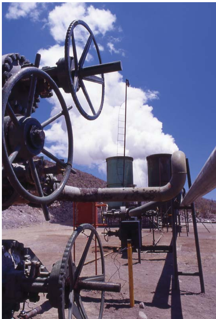
Las Tres Vírgenes Geothermal Field.
