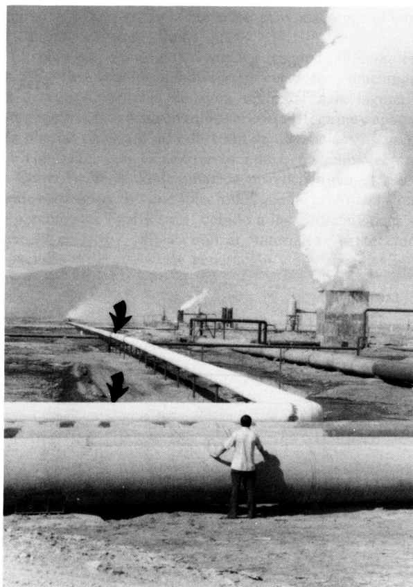
Figura 10. Ducto de gases a la laguna de evaporación.
